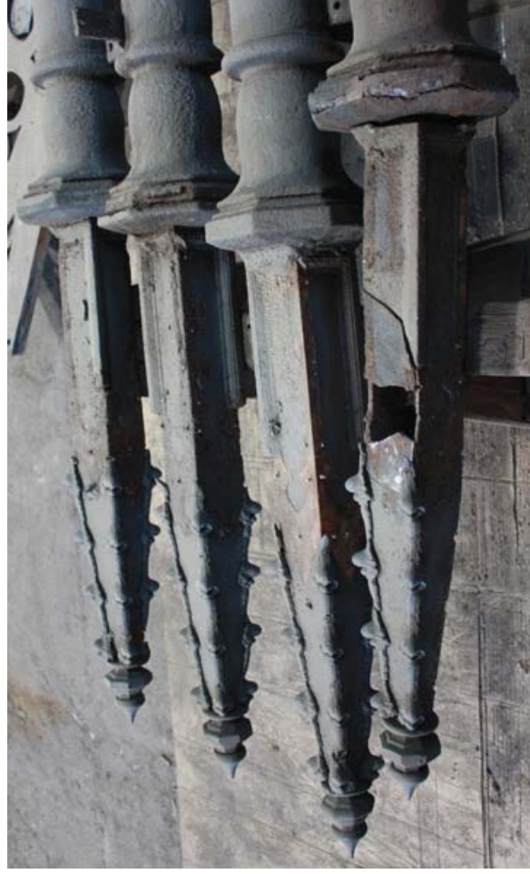
Fot. 9: Sterczyny z ołowianymi żabkami; po zdemontowaniu mostiężnych listewek i maswerków oraz listewek żeliwnych; widoczne spękania, korozja.
