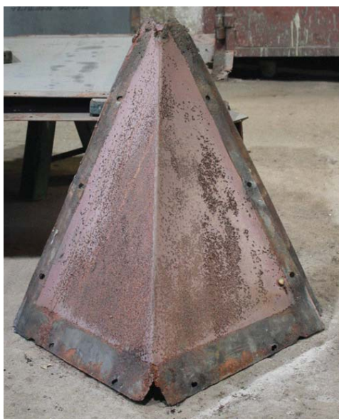
Fot. 17: Silnie skorodowana blacha stanowiąca pokrycie daszku.
